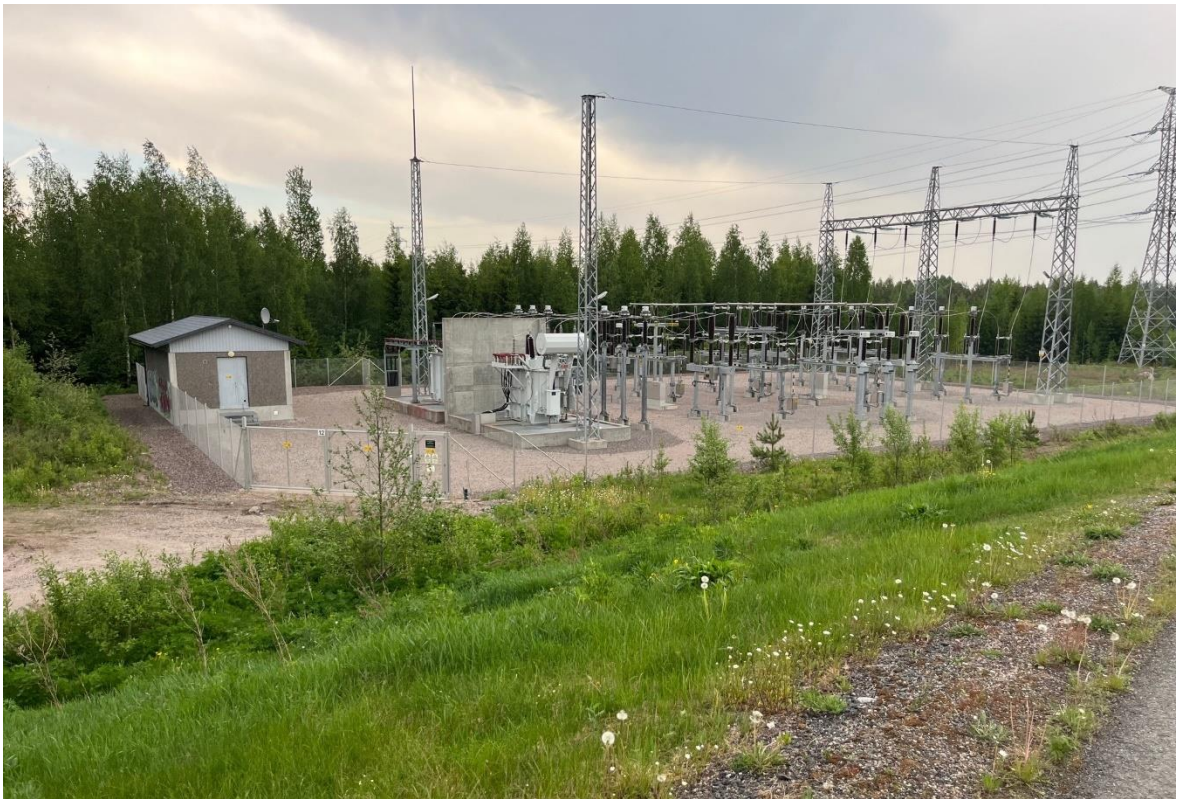
Kuva 7.3 Esimerkki sähköasemasta. Vasemmassa reunassa näkyy kytkinrakennus ja sen oikealla puolella betonisella alustalla on muuntaja. Muuntajan oikealla puolella ovat aseman katkaisijat ja erottimet. Tämä sähköasema sijaitsee Riihimäen Herajoella. Kuva: Sitowise Oy.
