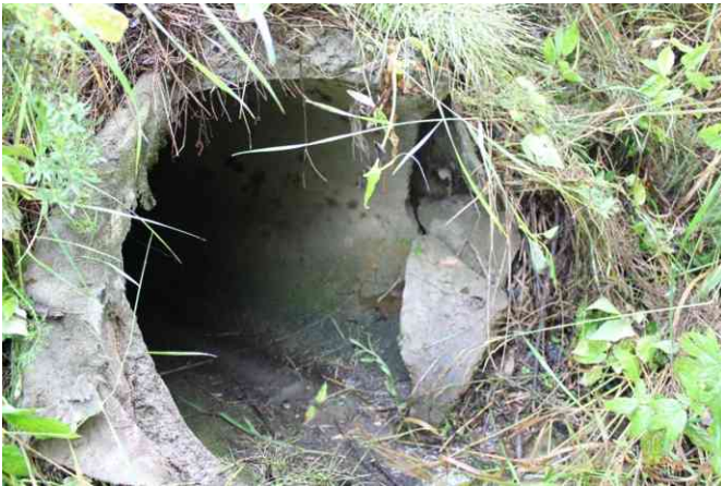
Kuva 11. B600 imupää rikkoutunut.
