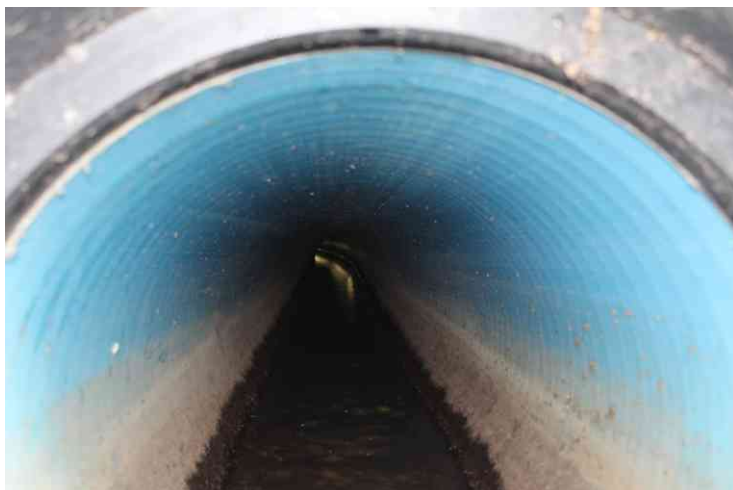
Kuva 36. Haapanantien alitus putket ovat mutkalla.
