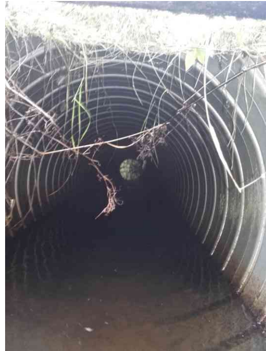
Kuva 2. purkupää,T 1200, oik. rumpu.
