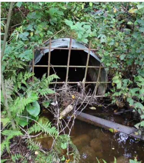
Kuva 42. Kuoleman järven purku-uoma on putkitettu Länsi-Himoksen tien alituksesta Patalahteen asti. Putki on alkupäästä T1000 putki, jonka edessä on kalterit, 20cm roskaa ja lietettä.
