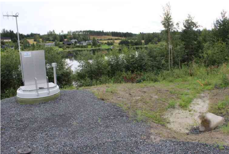
Kuva 6. B600 rumpu purkaa jv-pumppaamon viereen.
