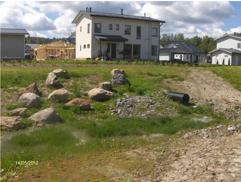
Rambollin suunnitteleman Kangasalan Vaarinmaan hulevesien hallintarakenteen luiskiin tehtiin heti kaivutöiden jälkeen nurmikylvö, mutta kylvämisen jälkeen sattuneet sateet huuhtoivat kylvöalueet osittain paljaksi ennen nurmen juurtumista. Luiskien suojaaminen eroosiosuojamatolla olisi auttanut kasvillisuuden juurtumista.
