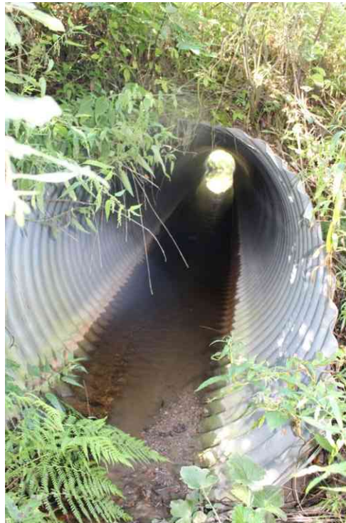
Kuva 51. Nakkerpohjassa (yt 16573) alittava T1800 rumpu. Kuva imupäästä. Purkupäässä 10 cm lietettä. (IMG_2050)
