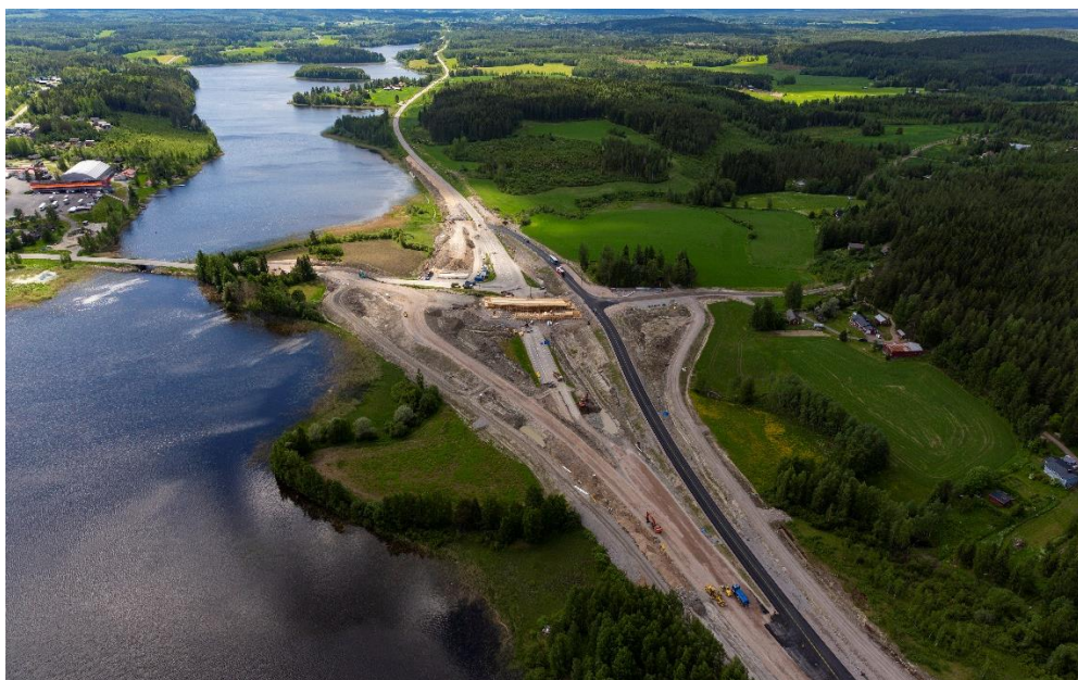
Kuva 15. Viistoilmakuva valtatieen kohdalta keskustan suuntaan, lounaaseen. Kuvan vasemmassa laidassa Himoksen aluetta. Kuva: Röni-Kuva Oy, 6/2022. Säyrylän eritasoliittymä valmistui loppukesällä 2022.
