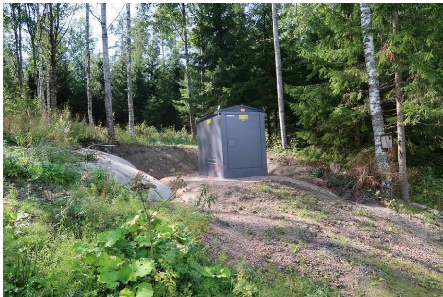
Kuva 13 Alueen käyttöä palveleva puistomuuntamo, joka on kaava-alueen ulkopuolella korttelin 8 lounaispuolella (Kuva: Kimmo Mustonen 25.8.2023)
